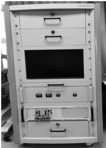
图 10 检测诊断系统实物
