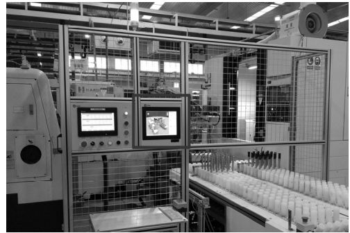
图 11 智能监控系统现场部署
